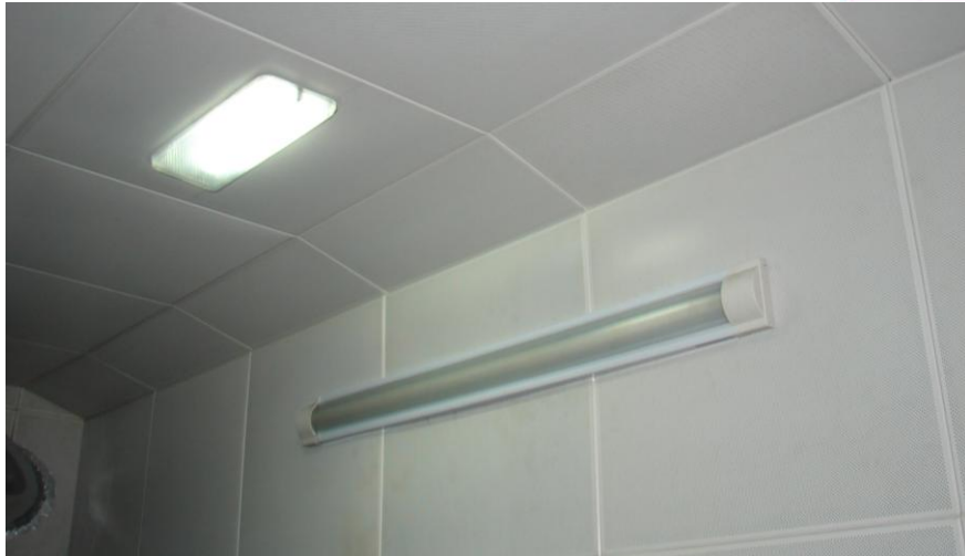
发电机组室内的照明
